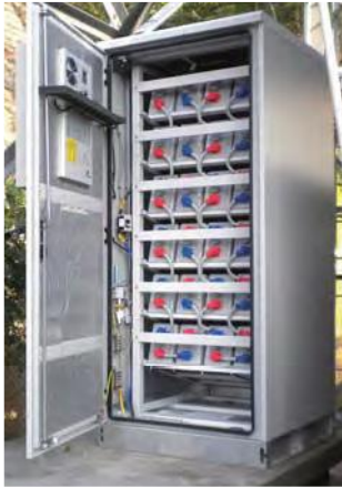
Batteries et son coffre
