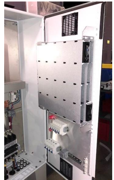
Rectifier & Breakers on the door
